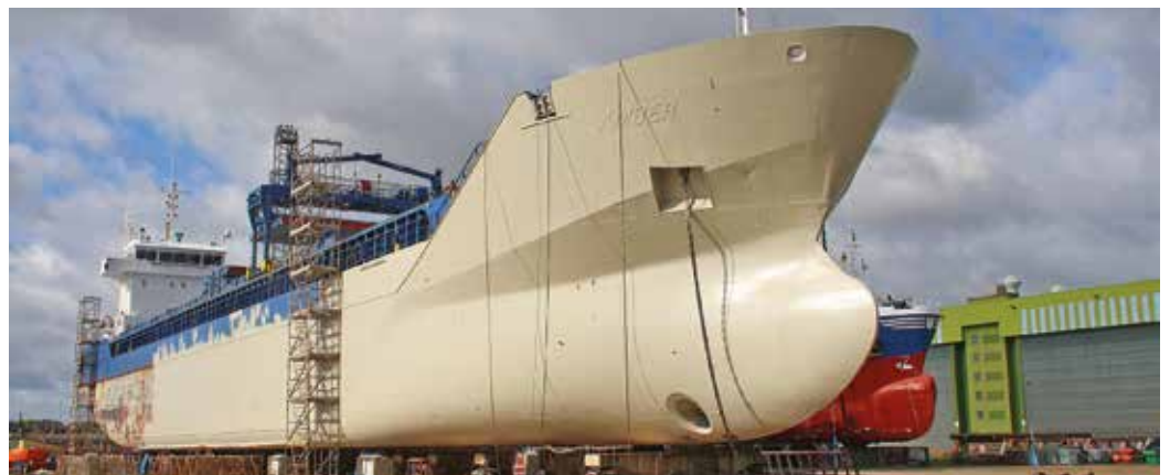
Solide Handwerksarbeit: Bevor der neue Anstrich kommt, wird erst die Grundierung aufgetragen
