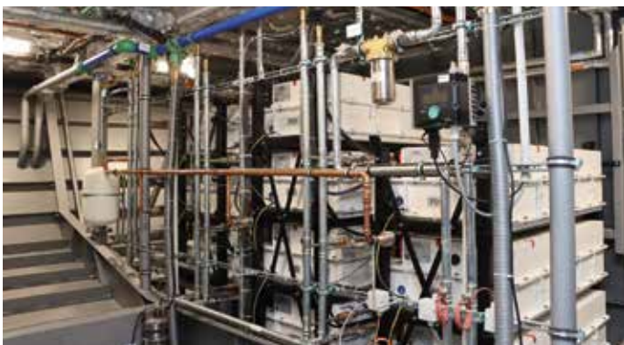
Blick in einen der zwei Batterieräume der „Adler nature“
